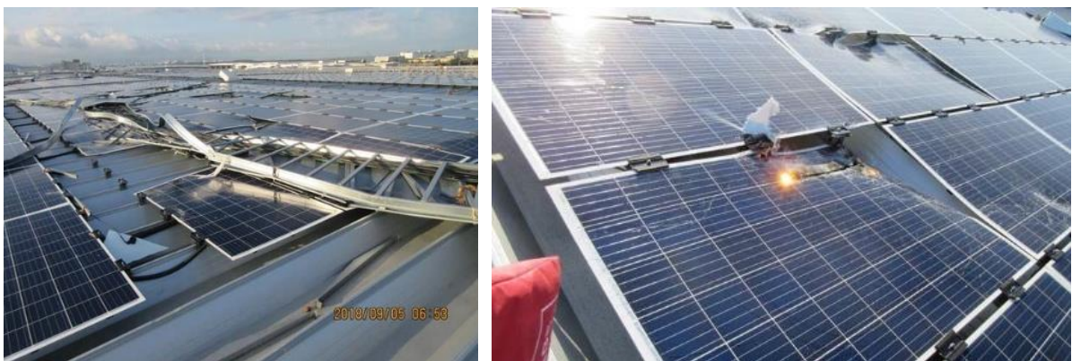
圖6、屋頂型 Mega Solar 損壞狀況[3]
