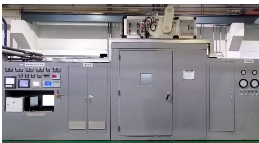
圖6、製冷3~30kW 壓縮機性能測試驗證平台(工研院綠能所沙崙院區)
