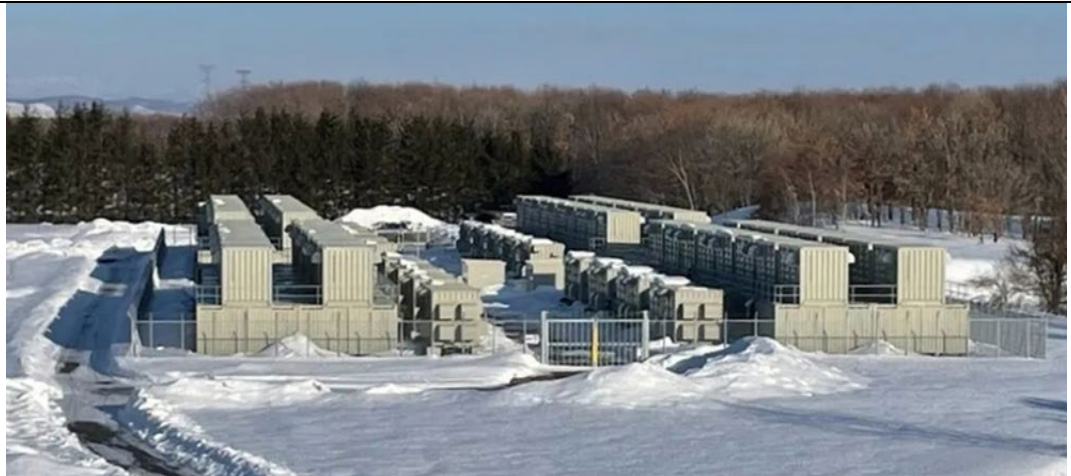
圖 3、日本住友於北海道建置 17 MW/51 MWh 大型儲能蓄電池
