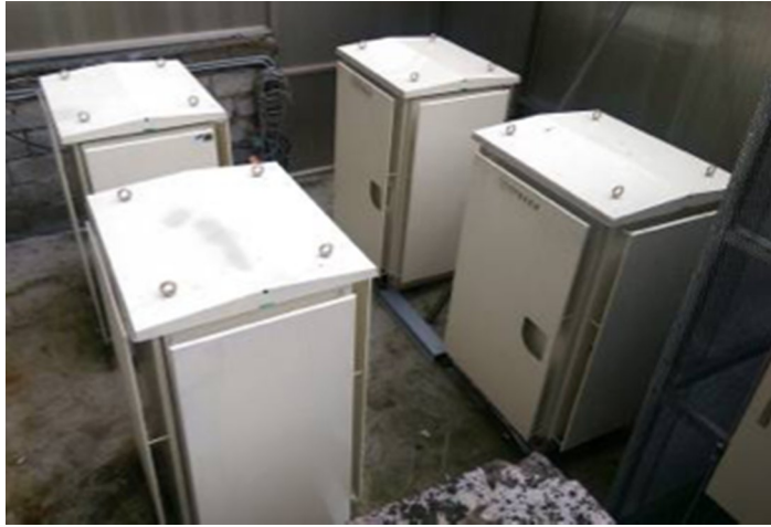
圖七 台北市體育局高抗災通訊平台 20kW 燃料電池備用電力系統
