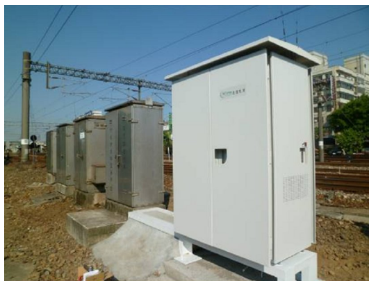
圖六 台鐵中壢車站號誌之燃料電池備用電力 RA 箱體
