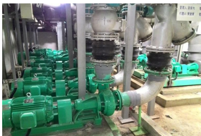
圖 9、工研院中興院區 89 館空調機房之一/二次冰水泵及冷卻水泵
