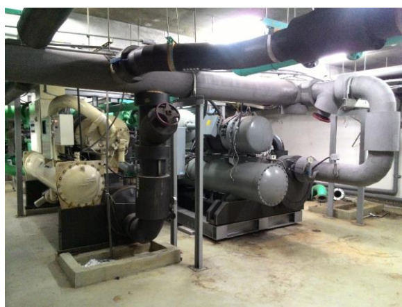
圖 8、工研院中興院區 89 館空調機房之 300 RT 變頻螺旋式冰水機
