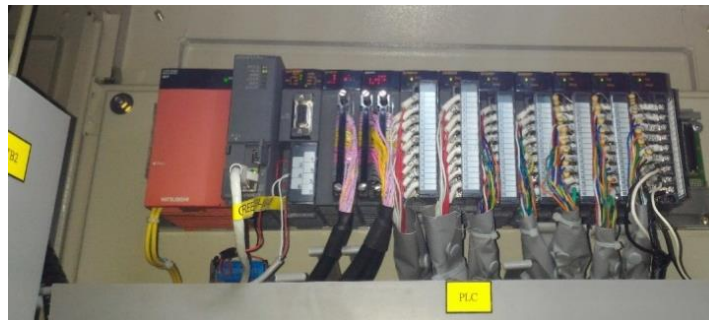
圖 11、工研院中興院區 89 館空調機房 PLC 架構之監控模組
