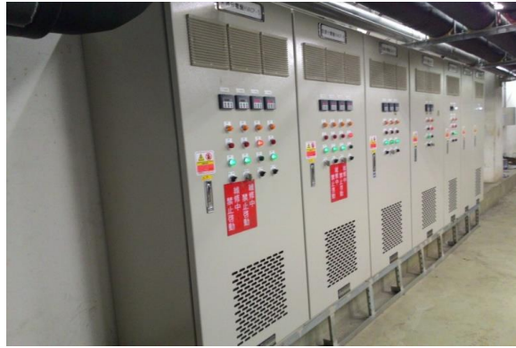
圖 10、工研院中興院區 89 館空調機房之變頻器盤及 PLC 控制盤
