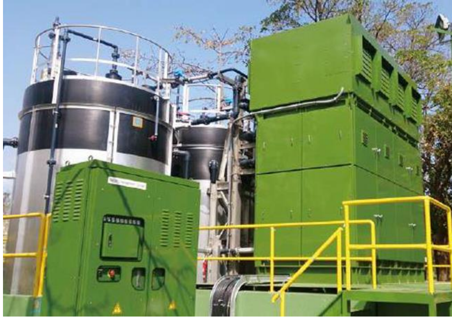
台灣電力公司綜合研究所引進之日本住友氧化還原液流電池試驗系統[8]
