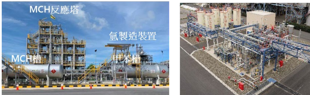
圖6、已完工的 MCH 相關裝置(汶萊置氫與川崎脫氫設施)
